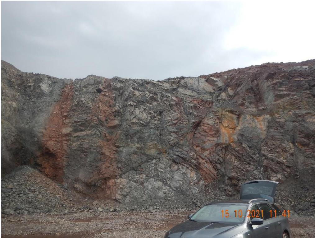
Abbildung 7: Vernässungsstellen auf der 4. Sohle im östlichen Böschungssystem (nördlicher Abschnitt).
