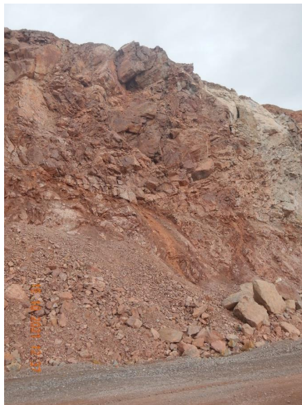
Abbildung 12: Ein teilweise vom umliegenden Gesteinsverband gelöster Block im östlichen Böschungssystem (3. Sohle). Es besteht potentielle Steinschlaggefahr.
