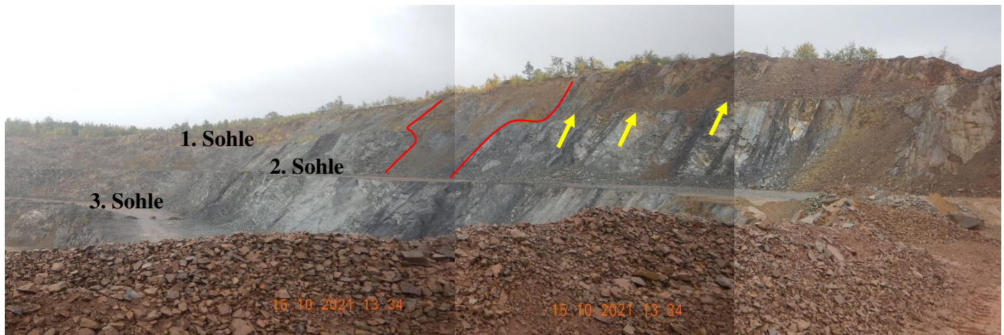
Abbildung 16: Blick auf das südliche Böschungssystem von der 2. Sohle. Die roten Linien begrenzen den Verbruchbereich zwischen Geländeoberkante und 2. Sohle. Die gelben Pfeile verweisen auf die überrollten Bermenabschnitte entlang der 1. Sohle.
