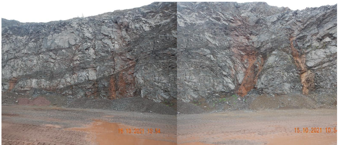
Abbildung 4: Blick auf das östliche Böschungssystem (südlicher Abschnitt) mit rostbraunen Vernässungsstellen.
