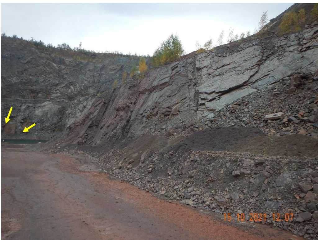
Abbildung 8: Geneigt und in Richtung Tagebau einfallende Trennflächen an der Zufahrt zur 5. Sohle im westlichen Böschungssystem. Stellenweise sind Kluftkörper von unten freigeschnitten. Die gelben Pfeile zeigen auf Vernässungsstellen.
