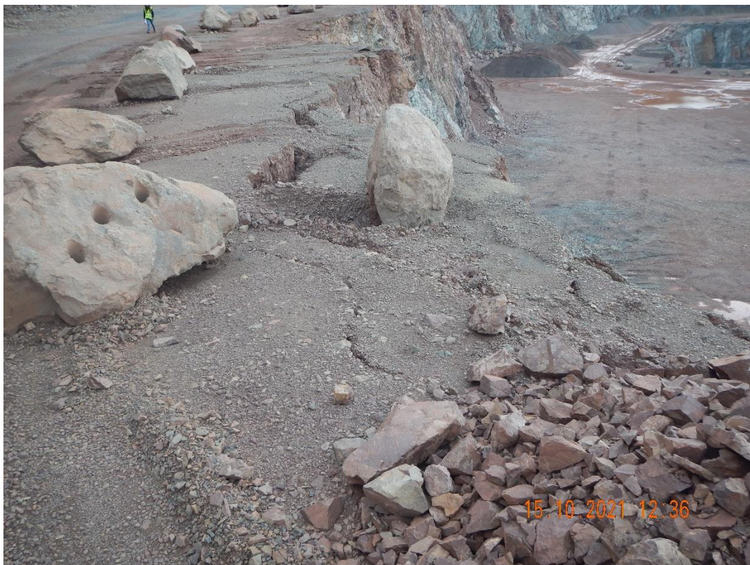
Abbildung 10: Lokale Risse und Abbrüche auf der 3. Sohle des östlichen Böschungssystems. Einzelne Freisteine weisen einen zu geringen Abstand zur Böschungsschulter auf und sind bei weiteren Abbrüchen kipppgefährdet.
